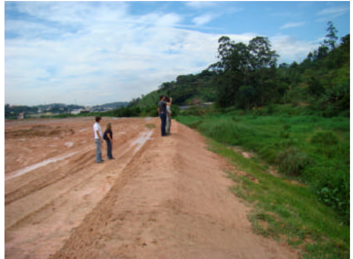
Foto 4 – Além de constituir o sistema de drenagem provisório, os diques de retenção auxiliam na delimitação do limite entre o DME Viterbo e Área de Preservação Permanente – APP.
